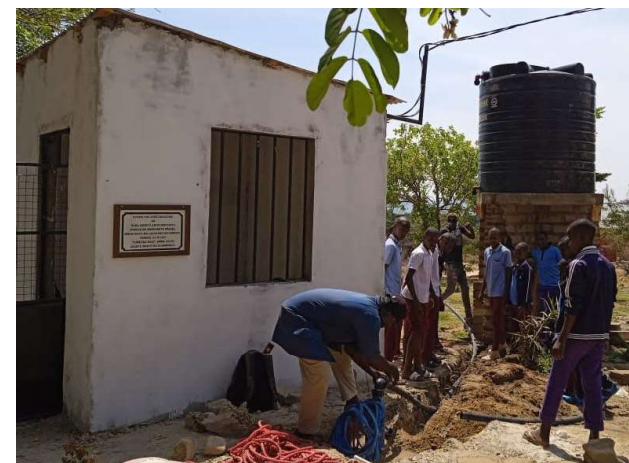
Foto 3: Der neue Brunnen mit Pumpenhaus und Wasserspeicher
